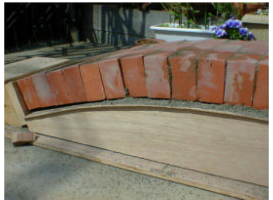
支保工と煉瓦の間に隙間ができる。
